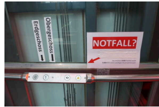
Bedienelemente im Aufzug
