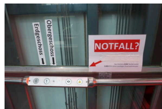
Bedienelemente im Aufzug
