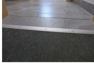
Schwelle an Eingangstür zum öffentlichen WC (im Restaurant)
