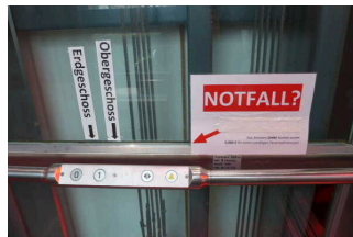
Bedienelemente im Aufzug
