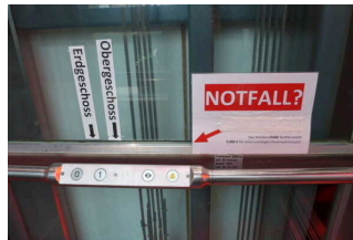
Bedienelemente im Aufzug
