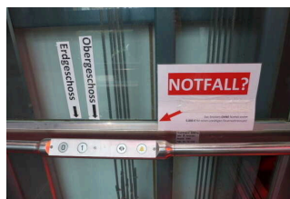
Bedienelemente im Aufzug
