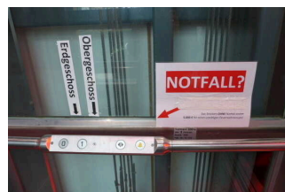
Bedienelemente im Aufzug
